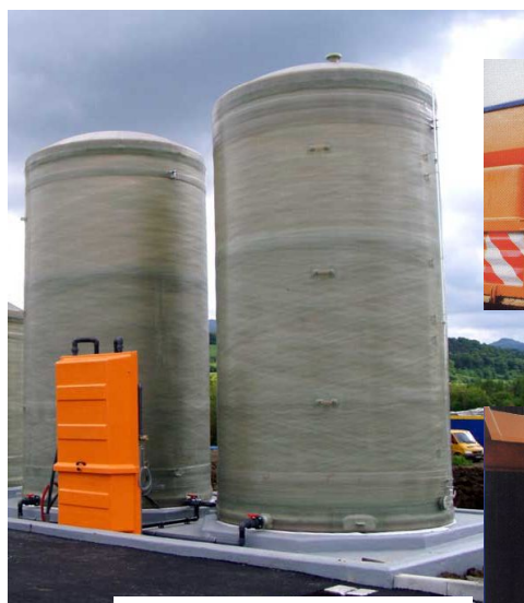
kompletna instalacja do rozcieńczania stężonego 34% roztworu chlorku wapnia ze stojącymi zbiornikami i urządzeniem SOLMIX
